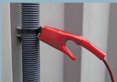
Techniques de suivi du tracé des câbles de petit diamètre
